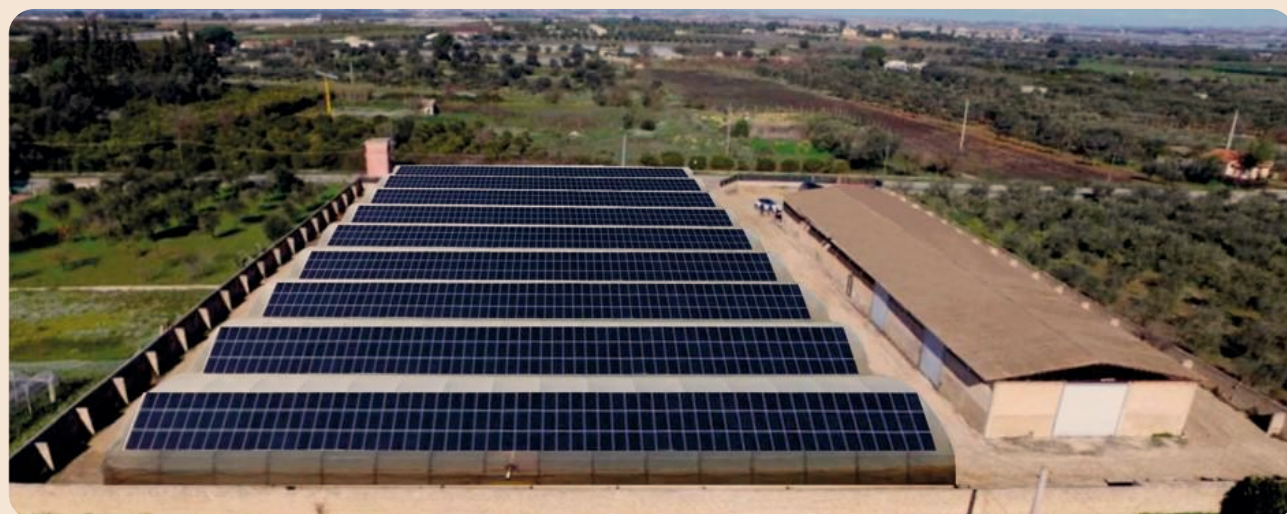
Vista dell'area e dell'edificio dove sono realizzati il campo fotovoltaico da 1 MW con accumulo da 1 MWh
